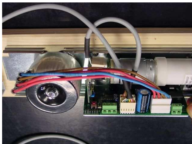
Centralina di controllo dopo il collegamento del motore sinistro
